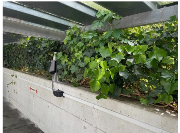
Carport mit Flachkabel, ein Abstellplatz Ready to Charge
